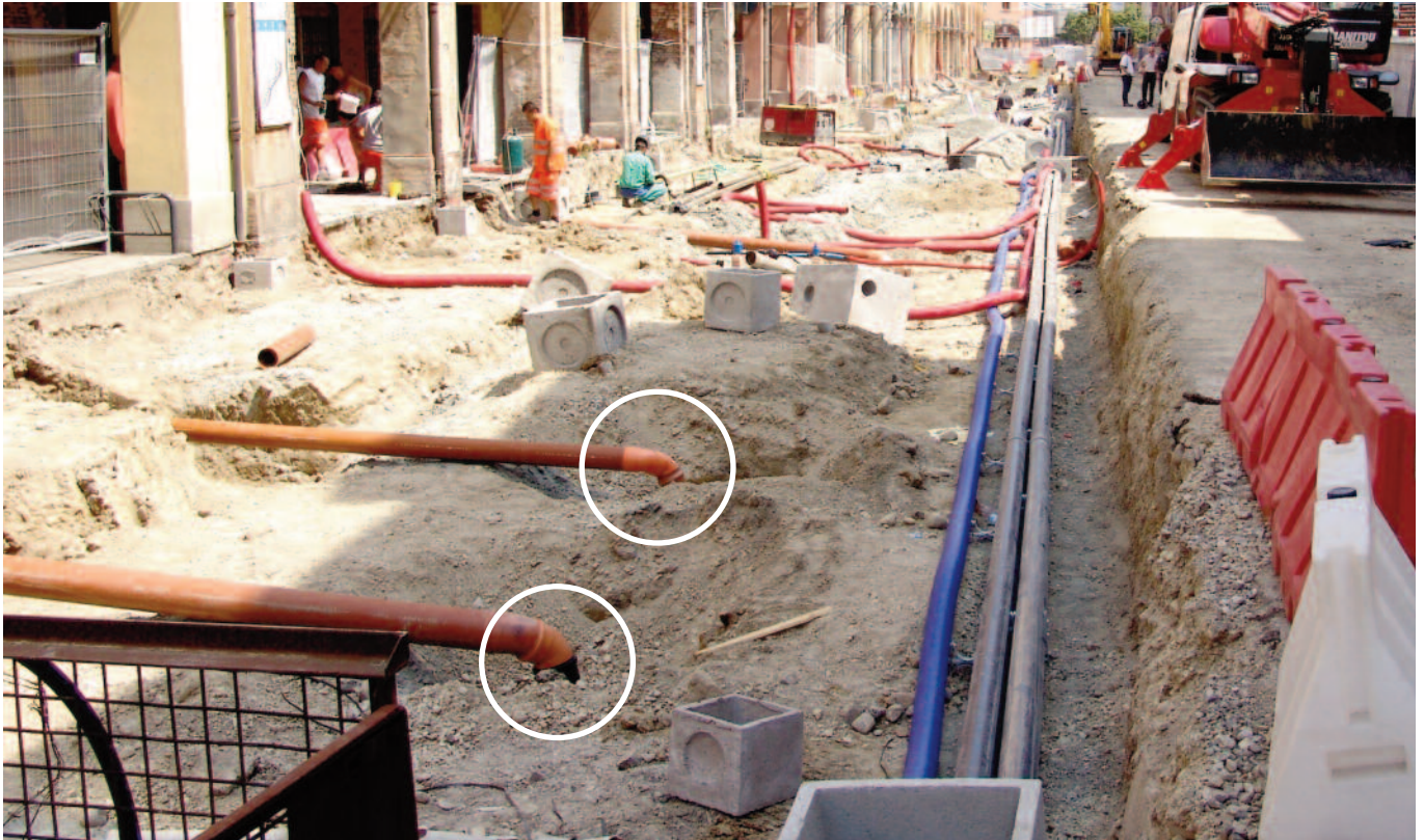
Easy Clip è stato utilizzato per gli allacci dalla rete fognaria comunale alle singole abitazione del centro storico. Easy Clip has been used to connect private sewers to the main collector of Italian historical downtowns.
