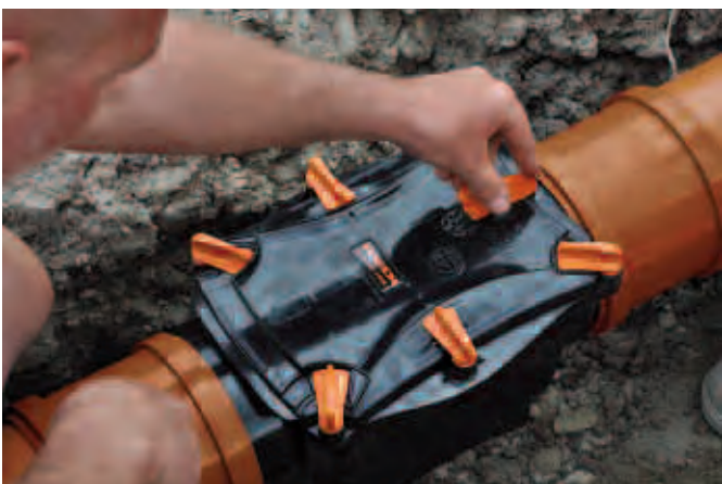
Apertura del coperchio di ispezione Opening the inspection cover
